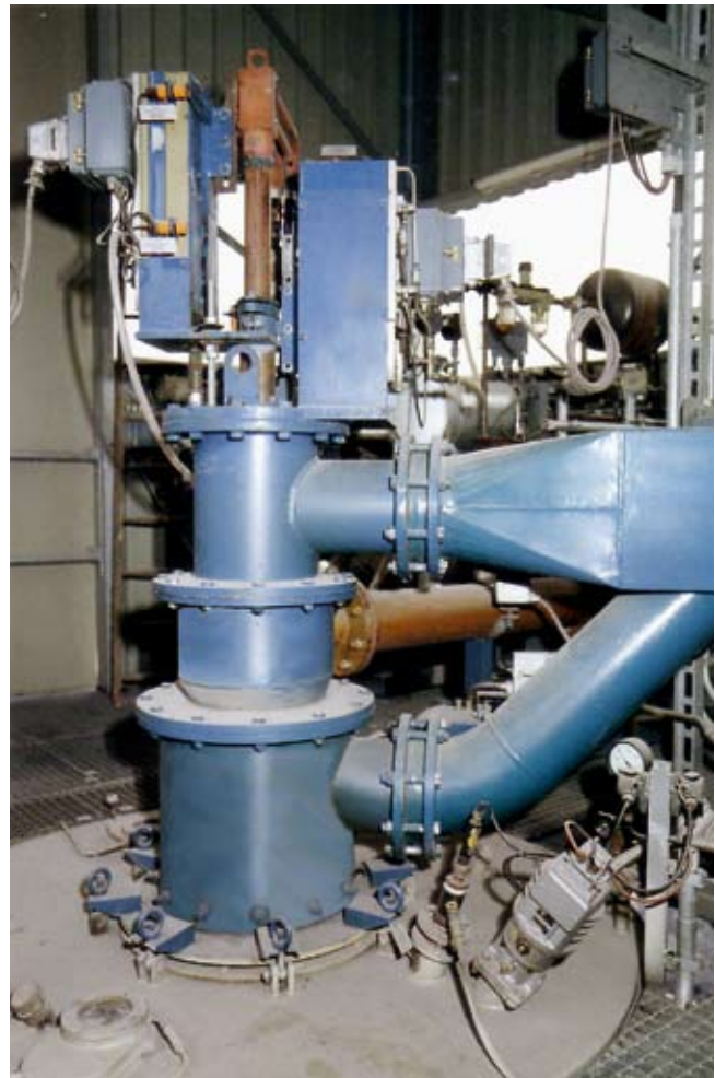
2 Brennkammerbrenner für Braunkohle und Heizöl EL, Leistung 8 MW 2 Burner for lignite and light fuel oil, capacity 8 MW
