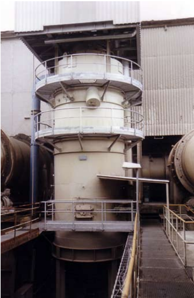
1 Gesamtansicht einer Brennkammer 1 Complete view of a burning chamber
