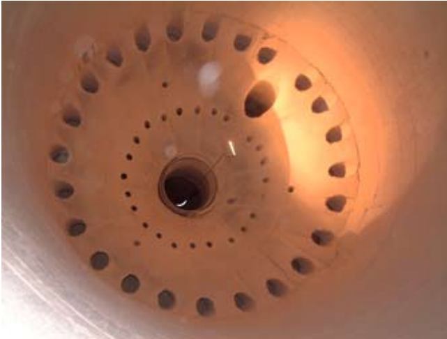
3 Brennkammerdecke mit Öffnungen für Brenner, Stufenluft und Mischluft 3 Roof of the burning chamber with openings for the burner, staged air and mixing air
